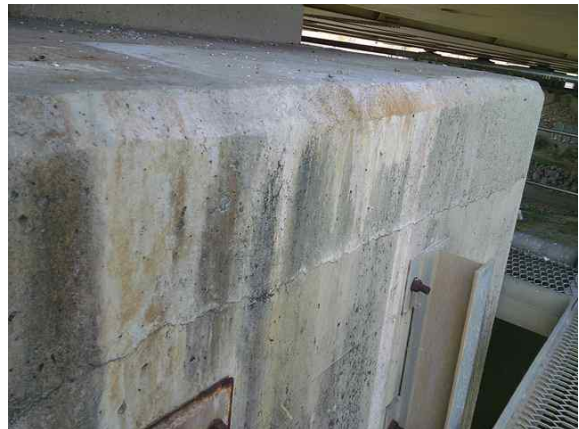
P8 코핑부 균열(폭 0.2mm)
